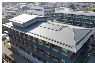
太陽光発電設備（本庁舎）
