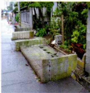
地震により、倒壊したブロック塀 (平成19年新潟県中越沖地震) 写真提供: 埼玉県
